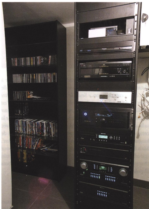
Le rack Middle Atlantic est installé dans une petite pièce située derrière l'écran.
